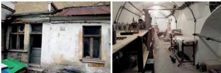
Nevyhovujúce priestory pre depozitárne účely
